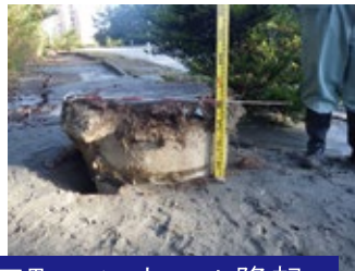
海王町マンホール隆起
