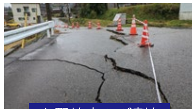
上野地内ひび割れ
